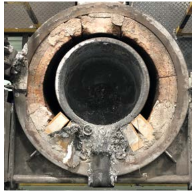
Abbildung 5: Der DURATEK Supermelt nach 1284 Schmelzladungen.
