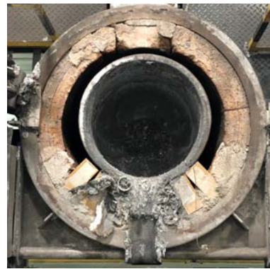
Abbildung 5: Der DURATEK Supermelt nach 1284 Schmelzladungen.
